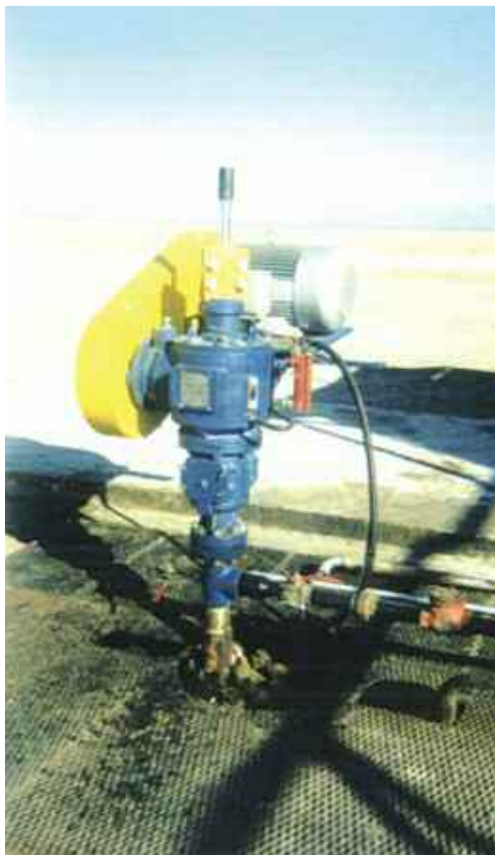
Figura 6: Boca de pozo LL-1003 con bomba PCP.
